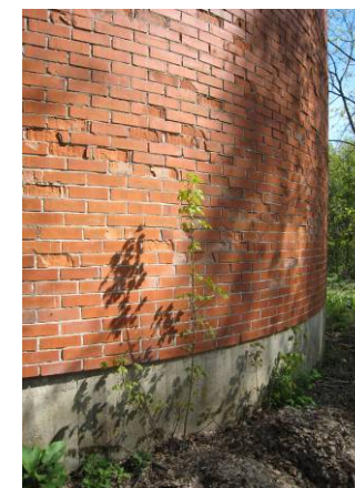
Bilderna 1459 ja 146 ovan: Pumpstationsbyggnaden 88 och bakom den ammunitionsförrådet. Reningsverkets fasadtegel har delvis vittrat.
