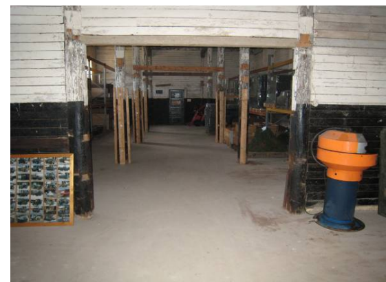
Bilderna 122, 123 och 1246 ovan och 1257 till vänster: Byggnaden har länge gjort tjänst som kall förrådslokal. Fukten har skadat ytterväggarna, sockeln samt de takstolar i trä som bär upp takfötterna. En del av de ursprungliga dörröppningarna har murats igen. Inomhus finns de ursprungliga spiltorna kvar. Golvet har renoverats. Byggnaden har uppförts som en förlängd version av typritningen invid. (Bild Haila 1993 K 26).
